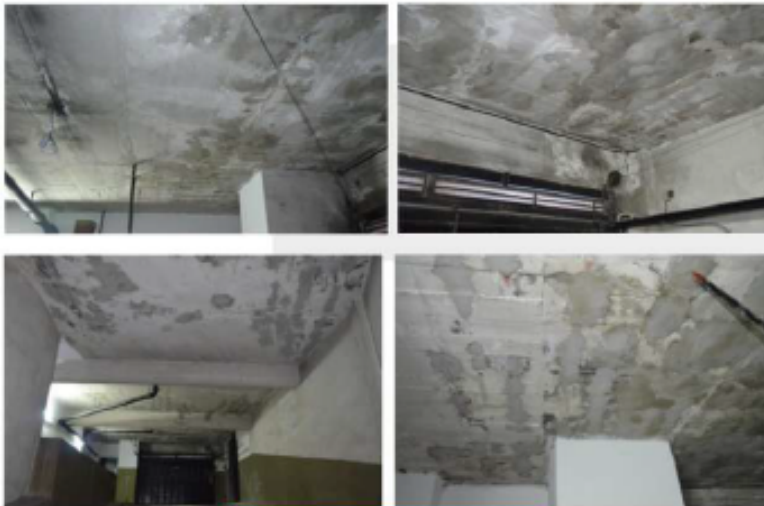
Vista de las fallas en la losa dañada
